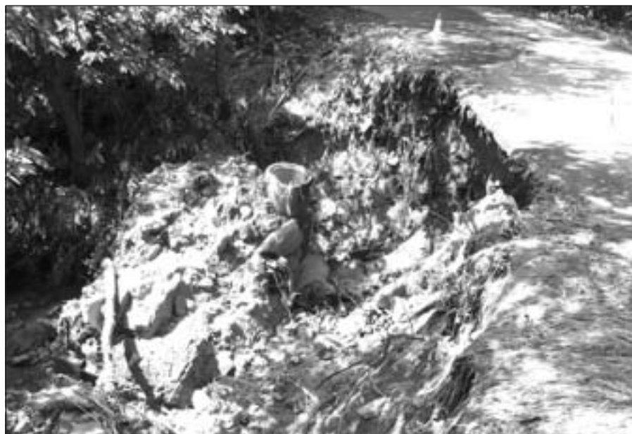
Zničený propustek u Sv. Voršily - Zborov
